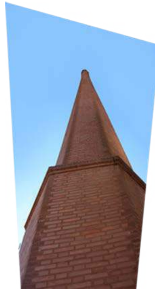
Azulindus y Martí cuenta en sus instalaciones de una de las antiguas chimeneas de los hornos árabes.
